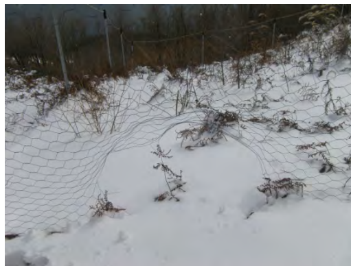
写真 2 No8 破損状況
