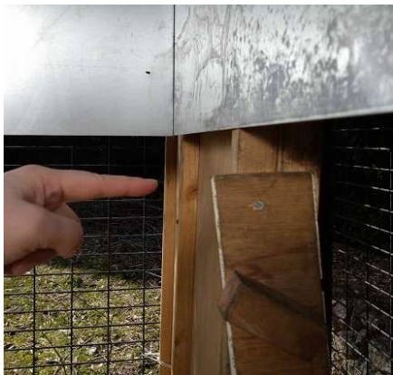
写真9 破損した板の一部
