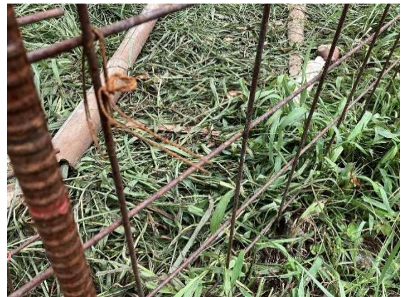
写真5 千切れたU字結束線
